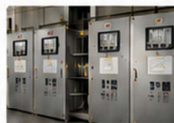
電気・制御機器
